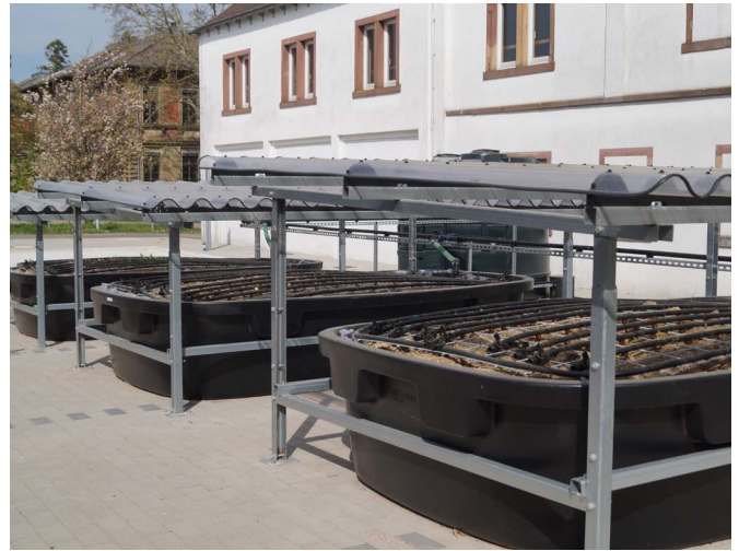
Füll- und Waschplatz für Pflanzenschutzgeräte: In Erdbehältern werden die Pflanzenschutzmittel abgebaut. Foto: Jörg Jenrich/LTZ
